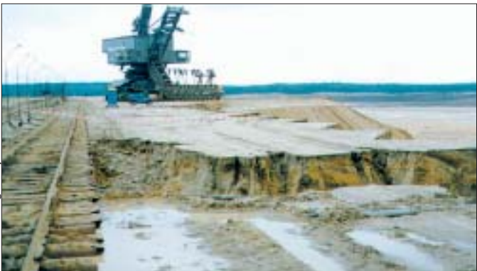
Starker Regen lässt Mitte August die Arbeitsebene des Eimerkettenbaggers im Sanierungstagebau Klettwitz-Nord wegbrechen.
