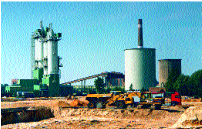
Mehr als drei Hektar kaufte der Abfallentsorgungsverband in Sonne. Auf dieser Fläche müssen auch alte Fundamente entsorgt werden. Fotos: Krause, Aniol, Körner
