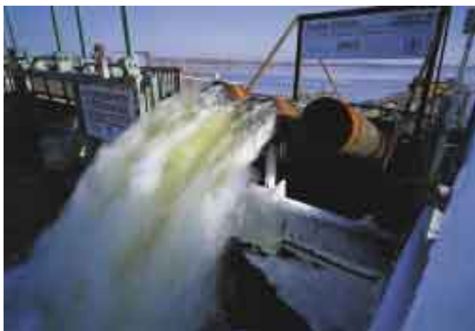
Temporäre Pumpstation an der Goitzsche
