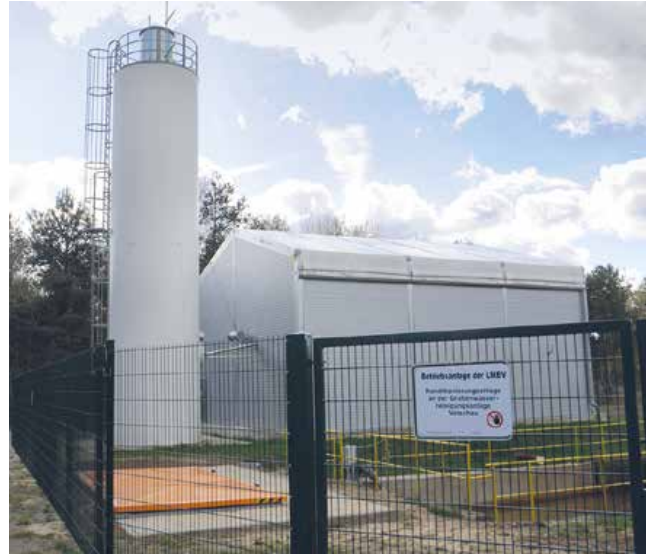
Konditionierungsanlage WBA Vetschau
