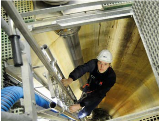
Blick in einen Horizontalfilterbrunnen
