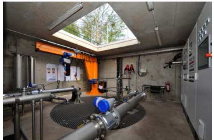
Brunnenstube eines Horizontalfilterbrunnens
