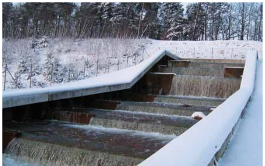
LMBV-Zulaufanlage vom Oberen Landgraben trotz Frost zum Jahresanfang 2009 in Betrieb
