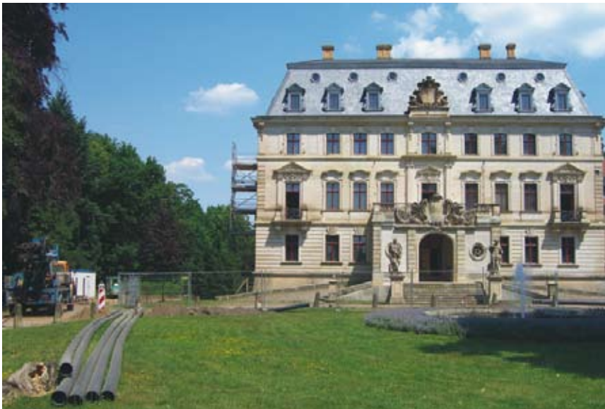
Vor dem Altdöberner Schloss liegen schon die Rohre für die Filterbrunnenentwässerung bereit.
