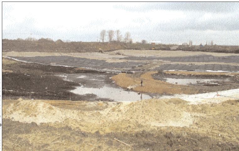
Das Foto zeigt den Arbeitsstand in der Grube im April. Deutlich zu sehen sind links die Kohletrübe, in der Mitte der als Zufahrt errichtete Damm, darüber das Geogitter und der Schotter.
