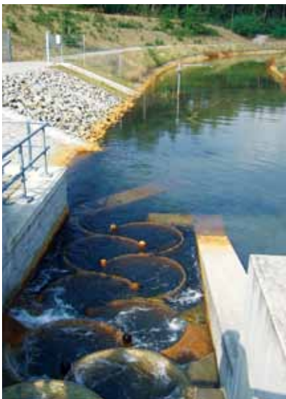
Wasserableitung über die Fischtreppe am Wehr in Burghammer in die Kleine Spree.
