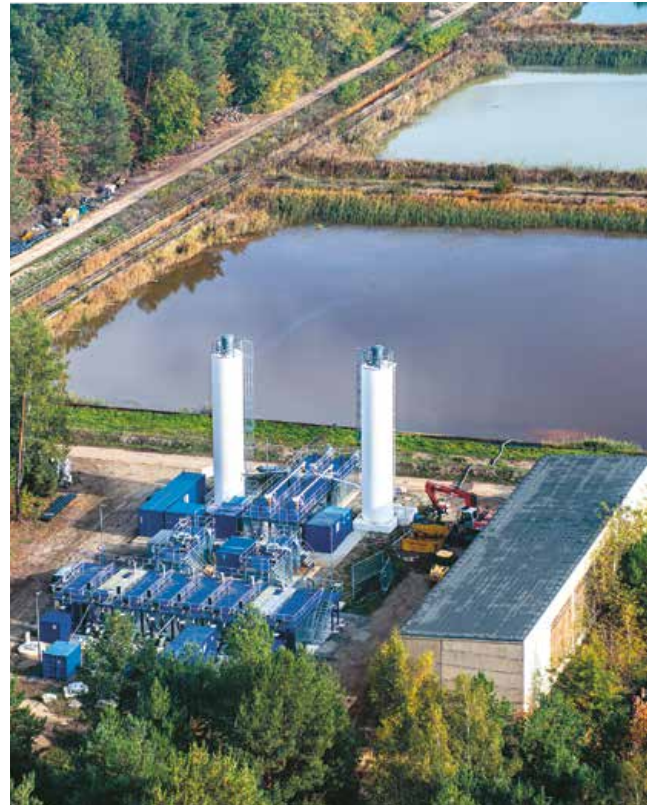
Wasserbehandlungsanlage der LMBV bei Burgneudorf
