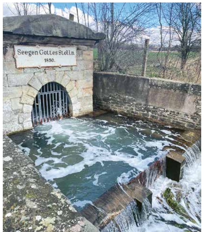
Mundloch des Segen-Gottes-Stollen während der Havarie
