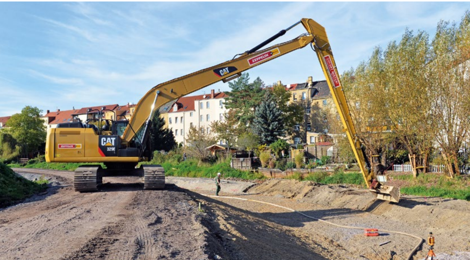
Bagger bei der Böschungprofilierung zum Loberausbau in der Innenstadt von Delitzsch (o.) Bau eines Horizontalfilterbrunnens zur Grundwasserabsenkung, Laugfeld in Senftenberg (u.l.) Rüttelstopfverdichtung am Ufer des Silbersees (u.r.)
