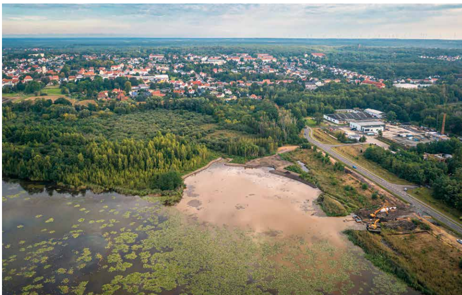
Die Arbeiten an der Südostböschung des Kuthteichs waren der letzte Sanierungsschritt zum Sichern der Restloches 38 in Lauchhammer.
