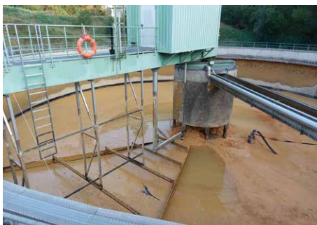
Im Kläreindicker setzen sich Eisen und Mangan ab. Der Eisenhydroxidschlamm wird abgepumpt und in das geflutete Grubengebäude Straßberg eingeleitet.
