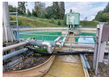
Nach der Schlammberäumung erfolgte die Wiederbefüllung des Kläreindickers. Im Anschluss wurde auch die Altanlage gereinigt.
