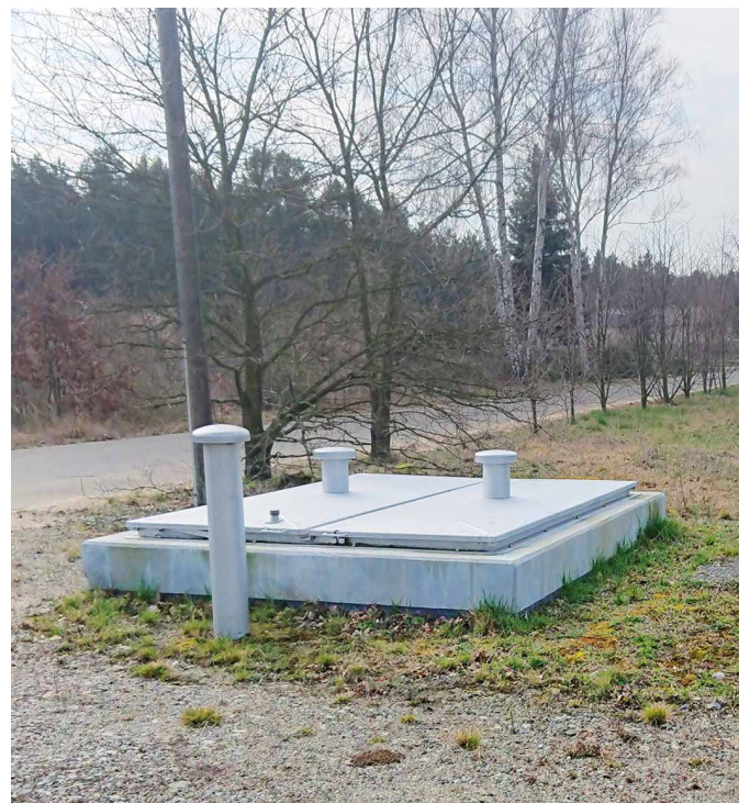
Oberirdische Ansicht eines Vertikalfilterbrunnens (Beispiel)
