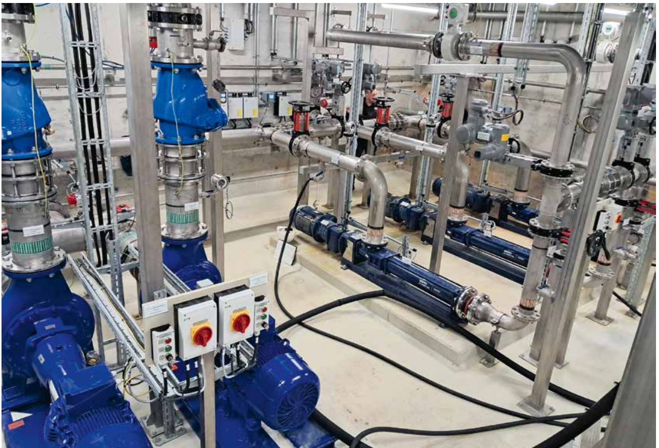
Technikraum der Wasserbehandlungsanlage Plessa
