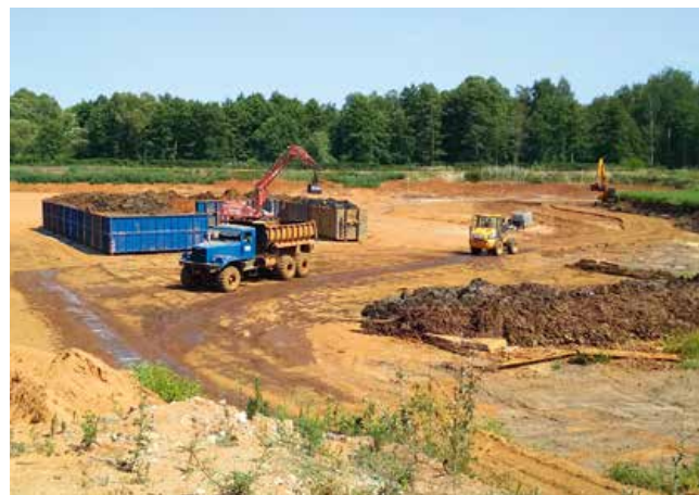
EHS-Entsorgung aus dem Sedimentationsbecken an der Vorsperre Bühlow
