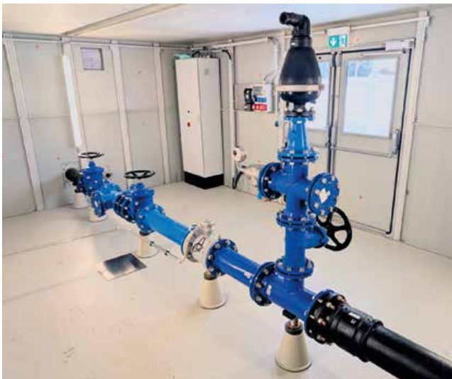
Prüfschacht 9 mit der Haldenwasserleitung Sollstedt
