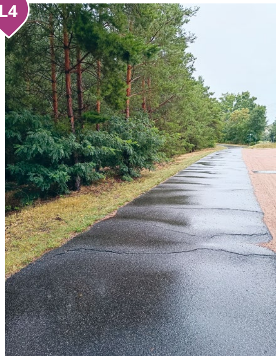
Rundweg am Dreieiberner See mit Schäden durch Wurzelaufbrüche
