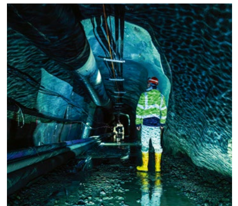
Sicher mit System – wichtig für den Bereich KSE
