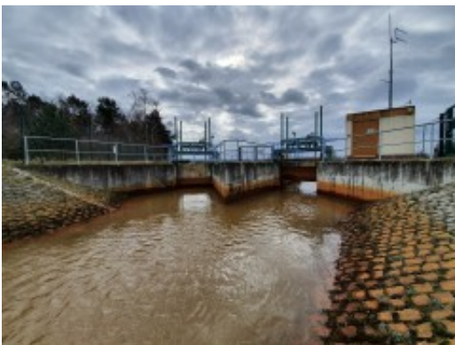
Wasserwirtschaftliche Anlage: Verteilerwehr Bluno
