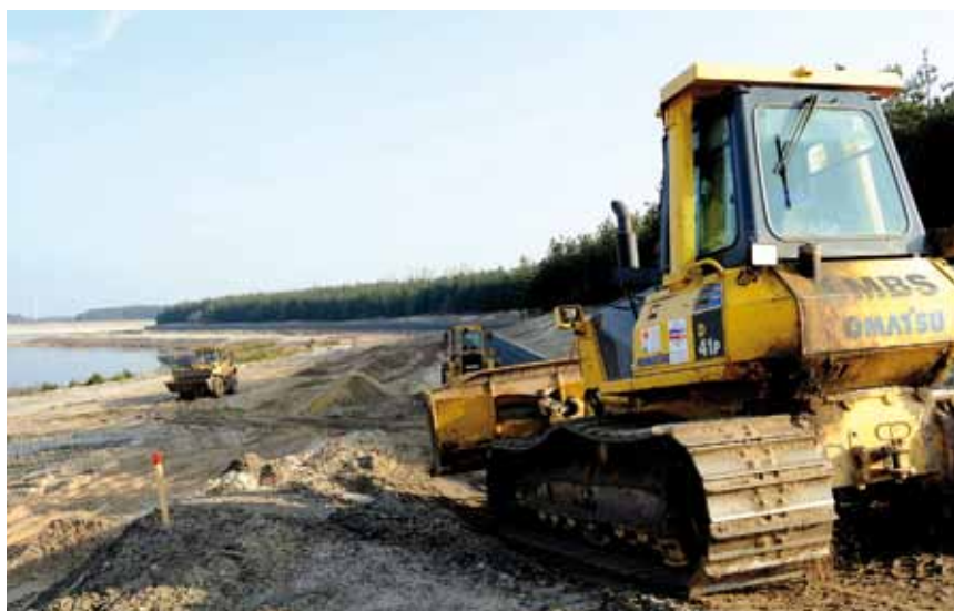
Arbeiten für die Böschungsgestaltung am Nordufer des Partwitzer Sees. Ein Gabionenverbau, der durch ein Drahtkorsett zusammengehalten wird, stabilisiert hier künftig die Uferböschung.
