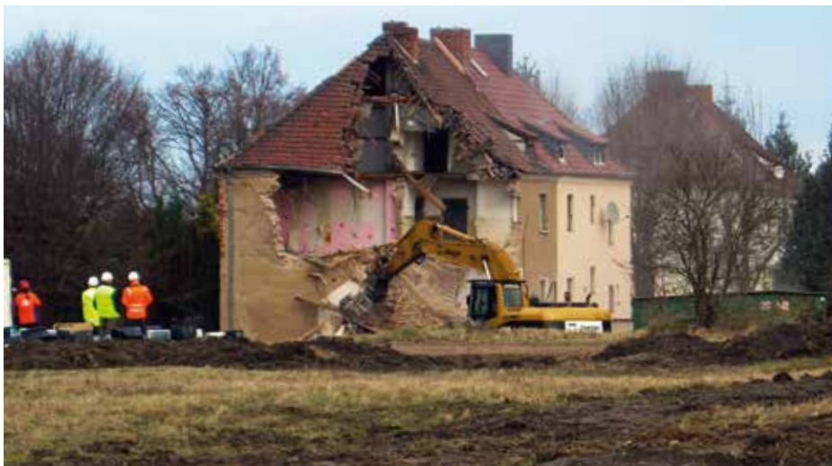
Beginn des Abrisses in der Siedlung „Am Ring“ unter Aufsicht der Bergbehörde.
